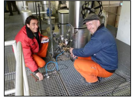
Die beiden Heizwerkführer bei den Funktionskontrollen.
