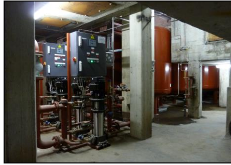
Druckhaltestationen mit Pumpendruckhaltung, Expansionsbehälter
